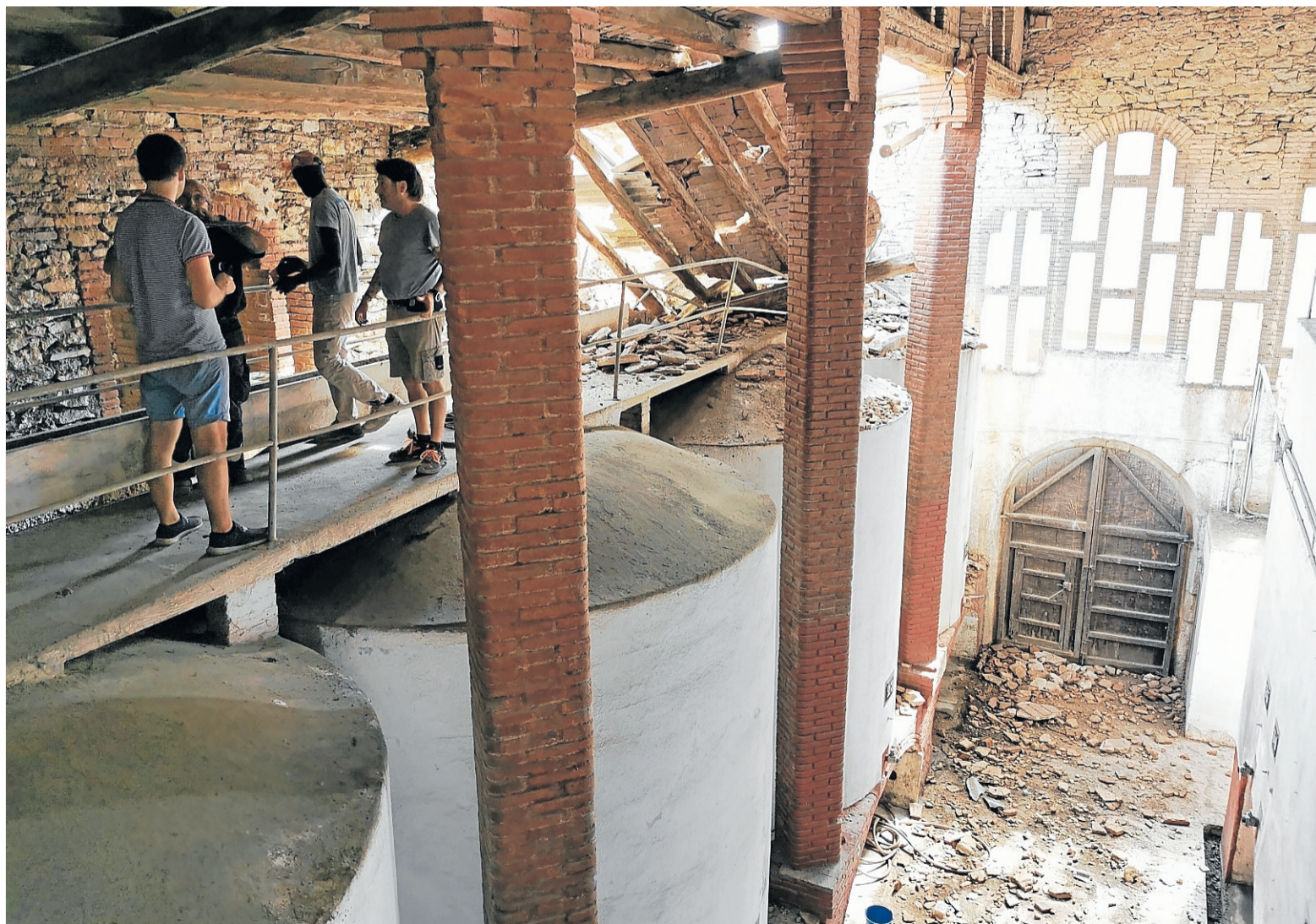
Técnicos y operarios evaluaron ayer los daños provocados en este edificio centenario. FOTO: ÀNGEL JUANPERE
